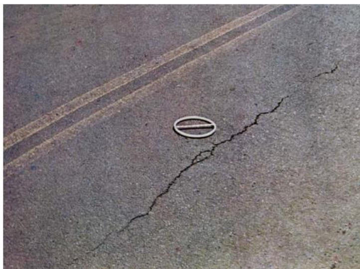
Figura 6- Trinca isolada longitudinal
