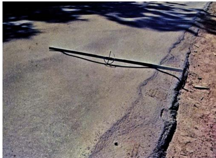
Figura 10- Afundamento de trilha de roda
