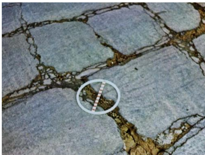
Figura 9- Trinca interligada tipo “bloco”
