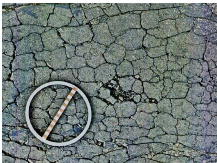
Figura 8-Trinca Interligada “couro de jacaré”
