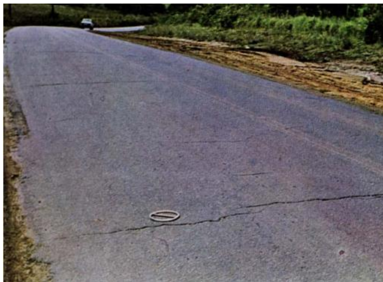
Figura 5- Trinca isolada transversal
