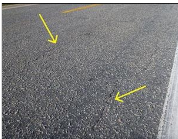
Figura 2 - Fissuras no pavimento
