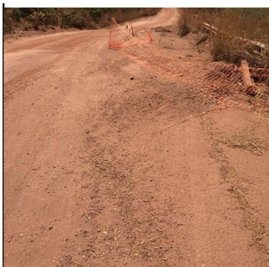
Figura 03 – Trecho sem pavimento
