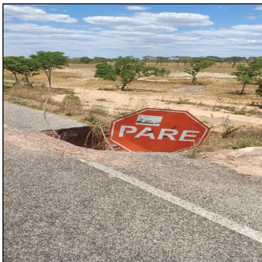
Figura 11 – Deslizamento de talude
