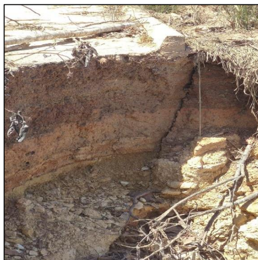
Figura 04 – Deslizamento de talude
