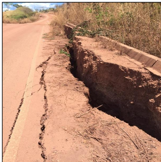
Figura 12 – Trinca, deformações e deslizamento de talude
