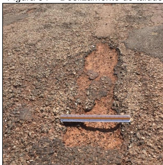
Figura 06 – Painela e desgastes
