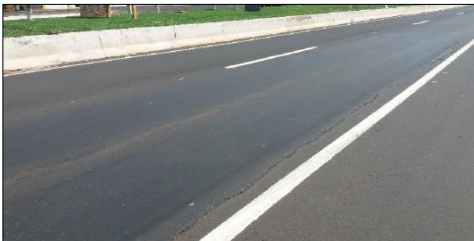
Figura 10 - Afundamento de trilho de roda
