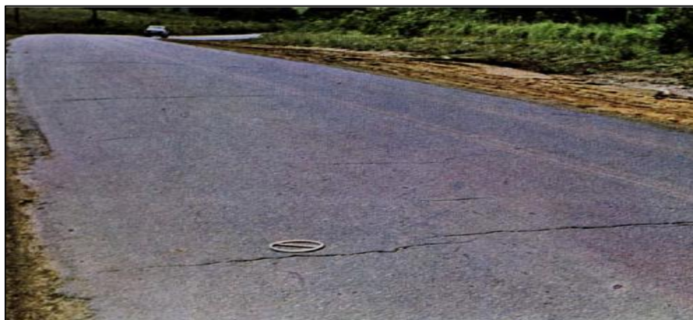
Figura 4 - Trinca Isolada transversal
