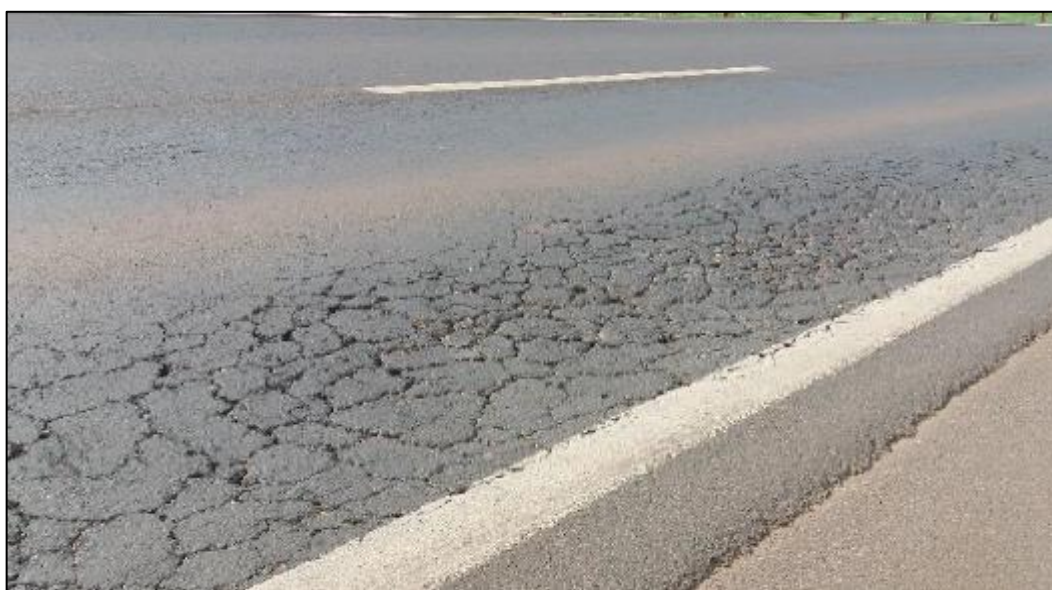
Figura 6 - Trinca interligada tipo jacaré
