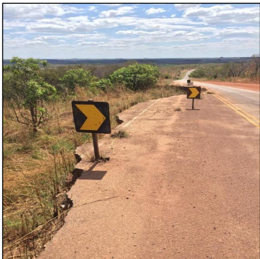
Figura 01 – Deslizamento de talude
