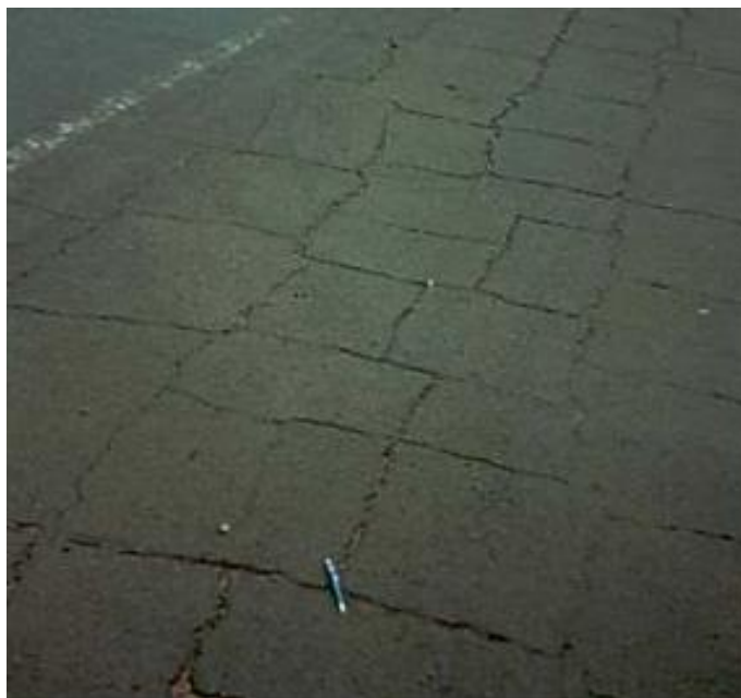
Figura 7 - Trinca interliga tipo bloco
