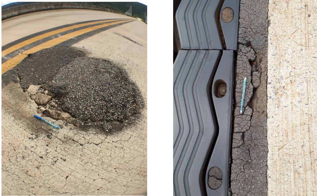
Figura 49: Reparo no Vão Central da Ponte e Junta de Dilatação (Fonte: Autor, 2020)
