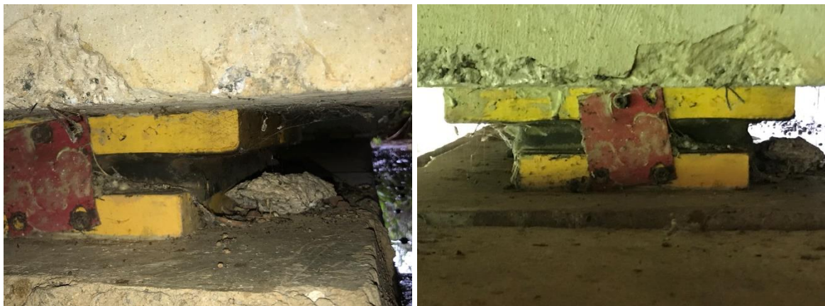
Figura 40: Aparelho de Apoio (Fonte: Autor, 2020)
