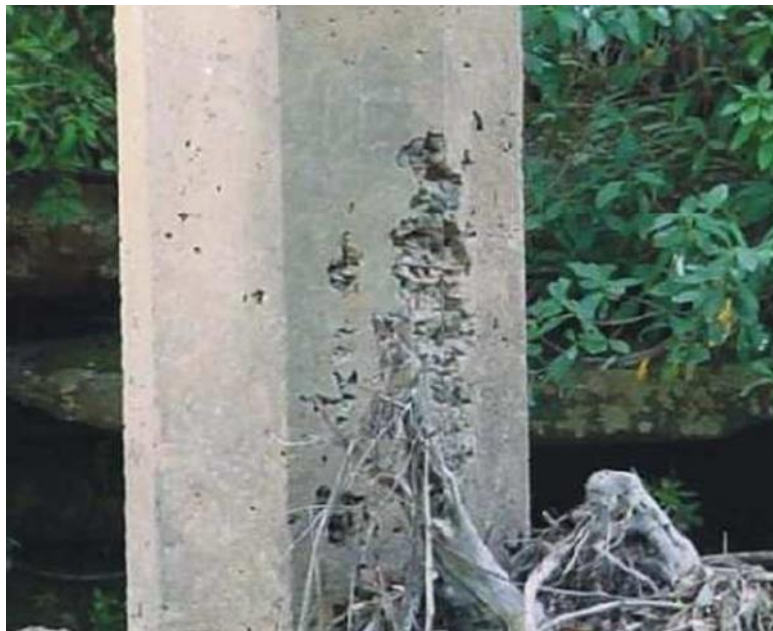
Figura 30: Vazios de Concretagem (Fonte: DNIT, 2004)
