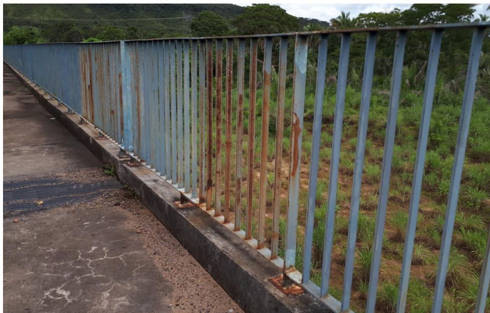
Figura 44: Guarda-Corpos (Fonte: Autor, 2020)
