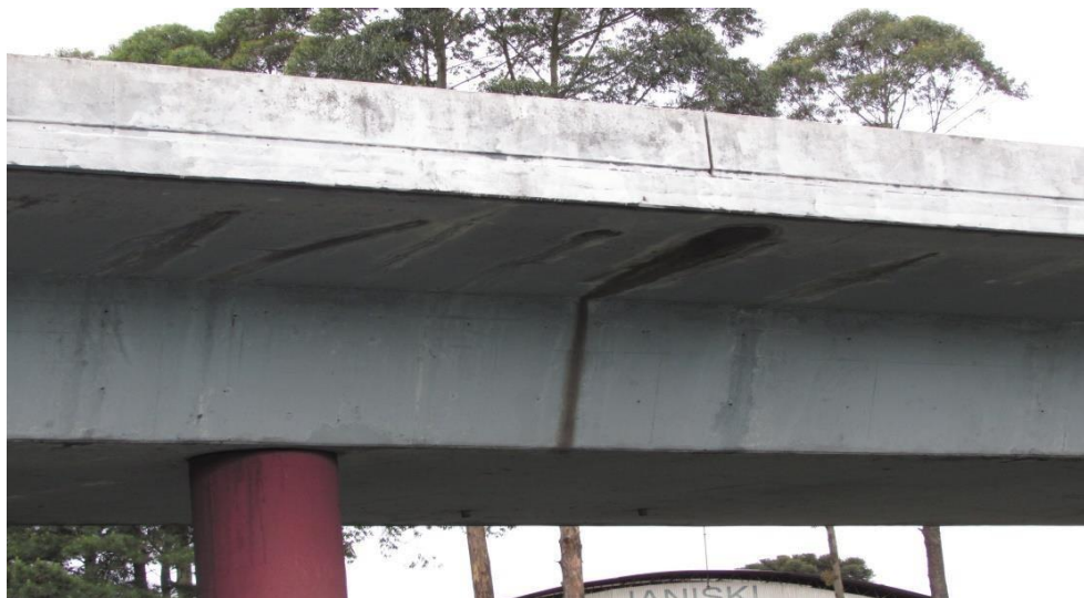
Figura 23: Manchas em ponte sem pingadeira (Fonte: Google Imagens)
