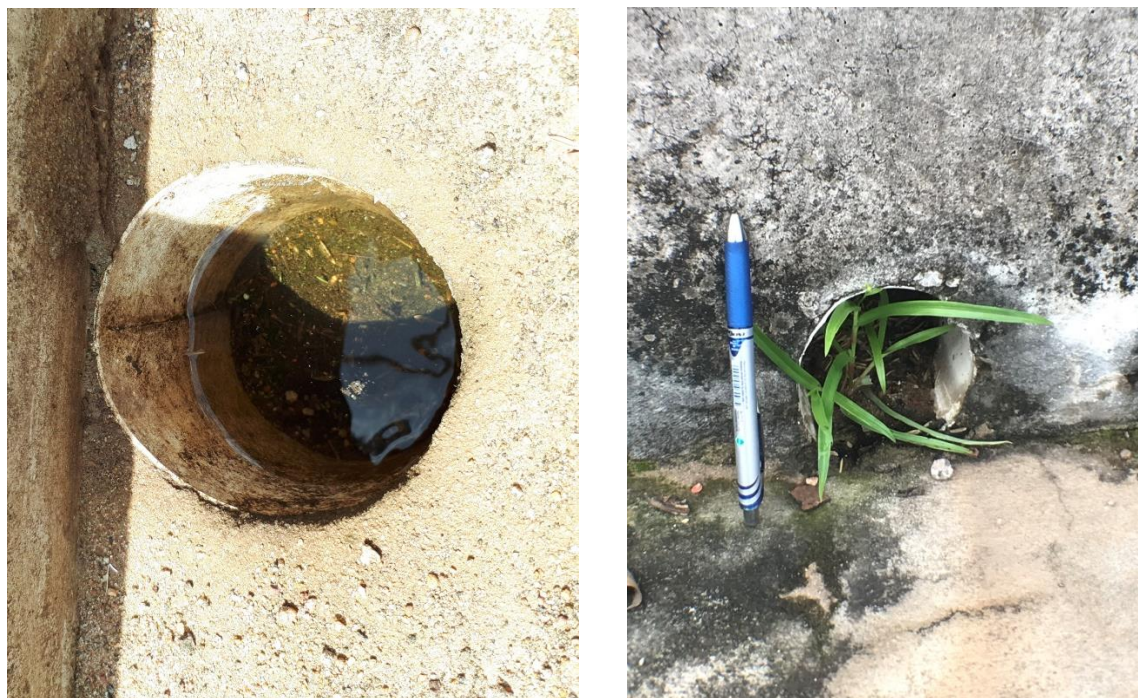
Figura 46: Dispositivos de Drenagem Obstruídos (Fonte: Autor, 2020)
