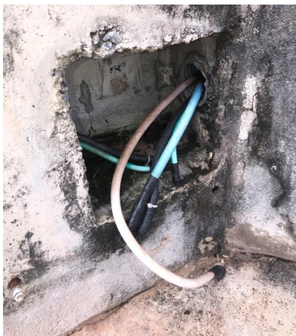
Figura 47: Caixa de Passagem de Fiação (Fonte: Autor, 2020)
