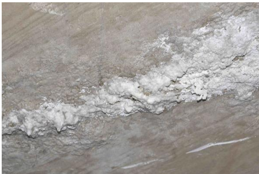
Figura 25: Efeito da lixiviação no concreto (Fonte: Sartorti, 2008).
