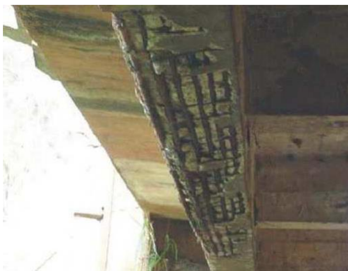
Figura 27: Corrosão da armadura aparente em viga de ponte. (Fonte: DNIT, 2004)
