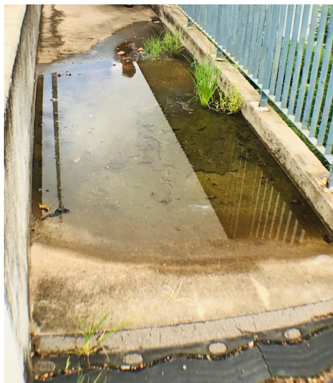
Figura 45: Acúmulo de Água no Passeio (Fonte: Autor, 2020)
