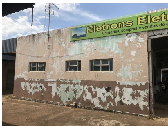
Figura 17 – Descolamento de pintura
