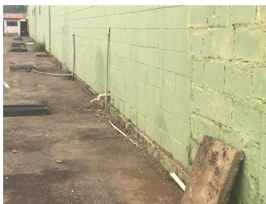
Figura 14 – Rede de esgoto
