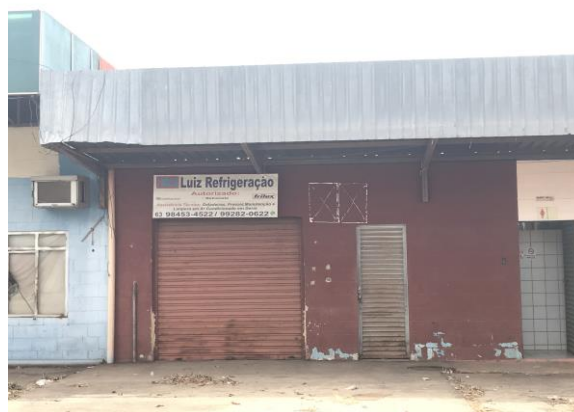
Figura 18 – Oxidação das esquadrias
