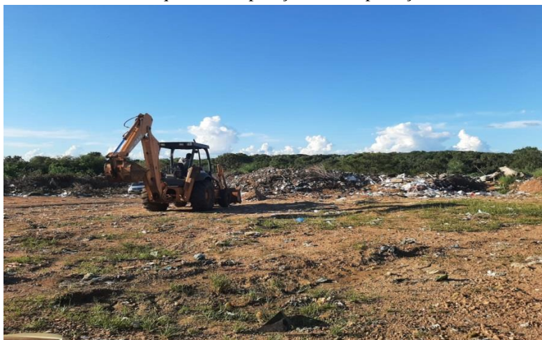
Foto 17 – Máquinas em operação de compactação do Lixo.
