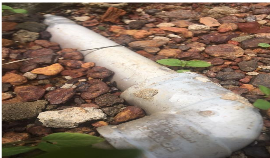
Foto 6 – Ressecamento da rede de água fria
