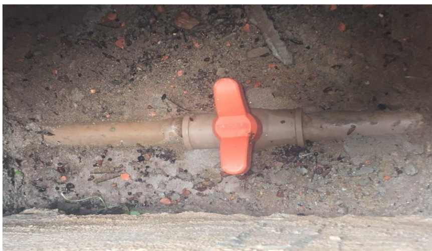
Foto 7 – Registro utilizado para controlar a pressão na rede de água fria
