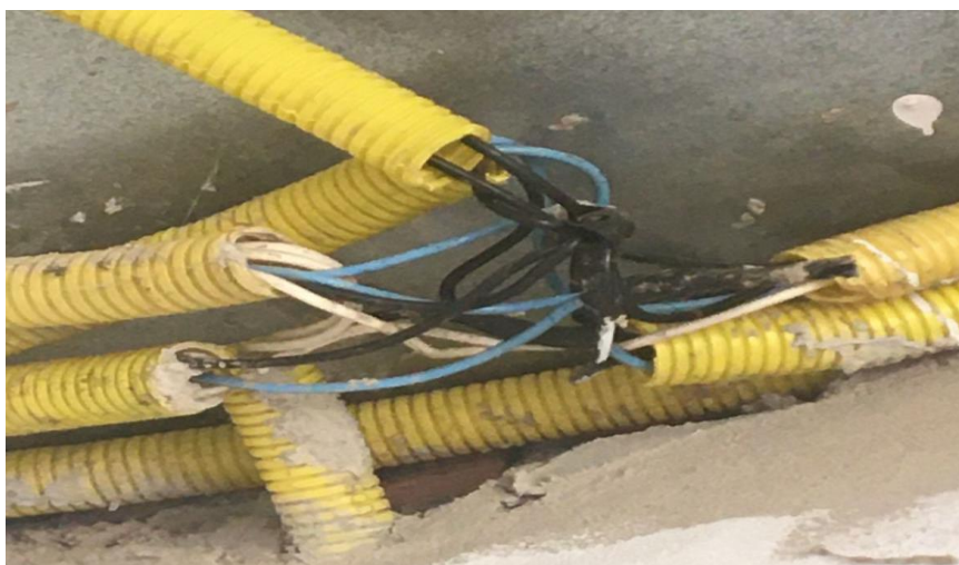
Foto 10 – Sistema de distribuição de energia
