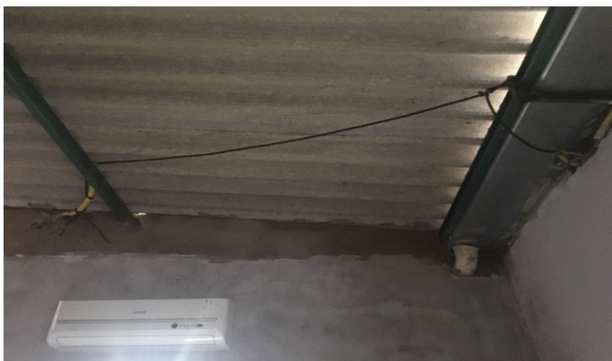
Foto 9 – Conexão direta de energia do ar-condicionado
