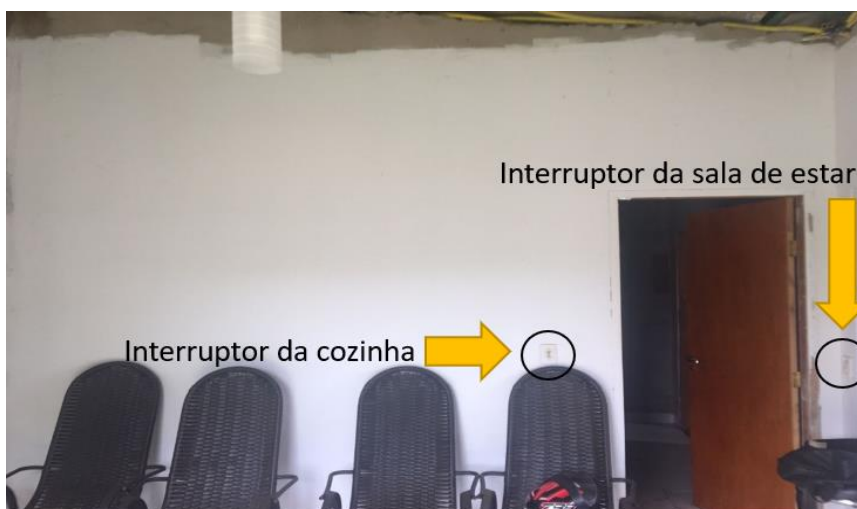
Foto 8 – Interruptor da Cozinha e Sala
