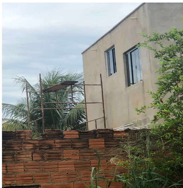
Figura 7: Suporte de madeira com risco de quebrar
