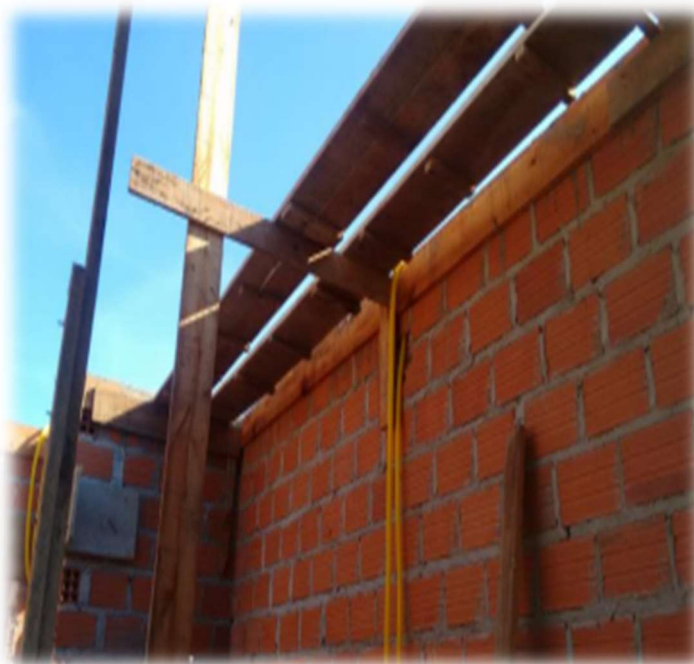
Figura 6: Passarela com risco de queda
