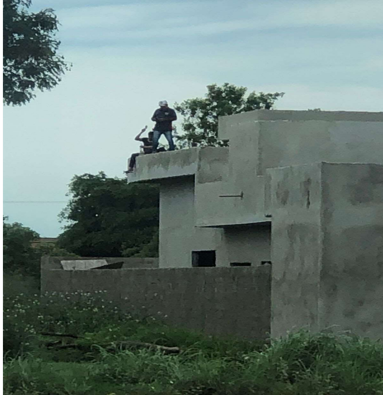
Figura 9: Trabalhadores sem EPIs trabalhando em altura
