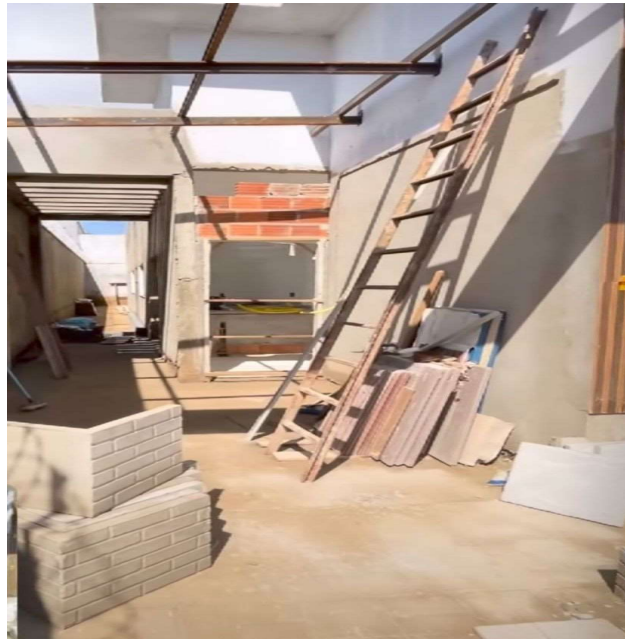
Figura 5: Escada irregular, com presença de rachaduras
