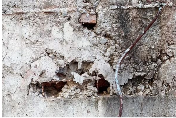
Figura 9: Segregação do concreto.
