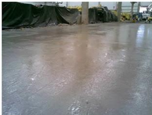
Figura 10: Exsudação do concreto.
