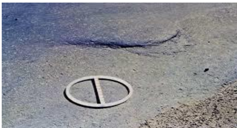
Figura 12 - Escorregamento Fonte: Norma DNIT 005/2003 – TER
