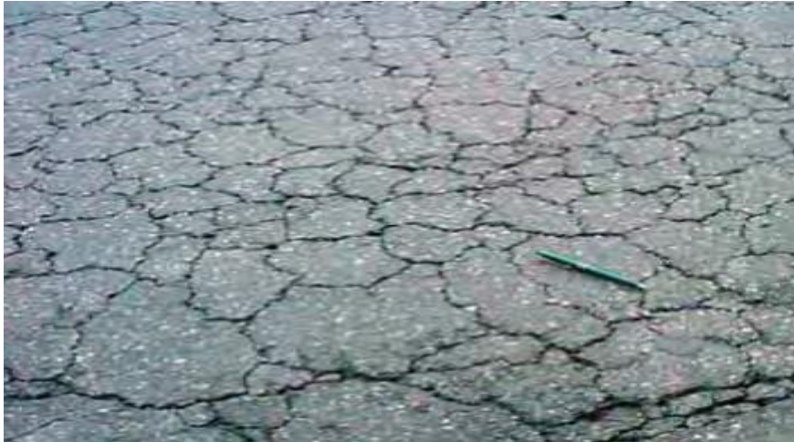
Figura 09 - Trinca tipo couro de jacaré Fonte: Norma DNIT 005/2003 – TER
