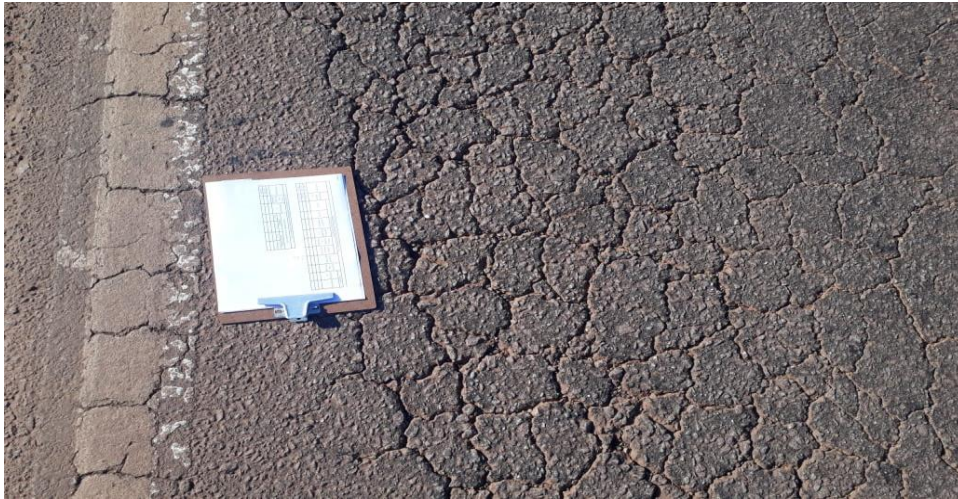
Figura 25: Trincas Interligadas Fonte: Próprio autor (2021)
