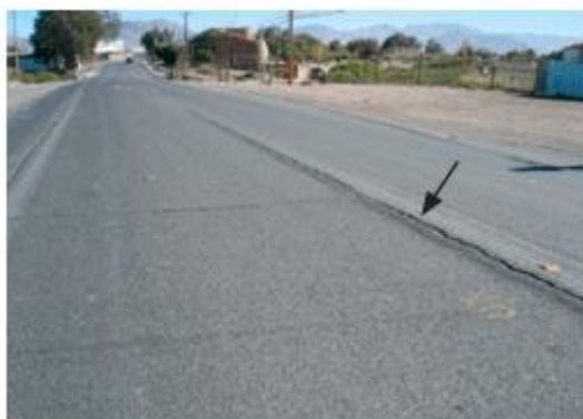
(c) Trinca de retração (TRR)
