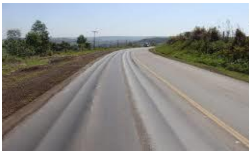
Figura 18 – Afundamento de consolidação Fonte: Strata Engenharia Ltda./posts/649293378448151:0
