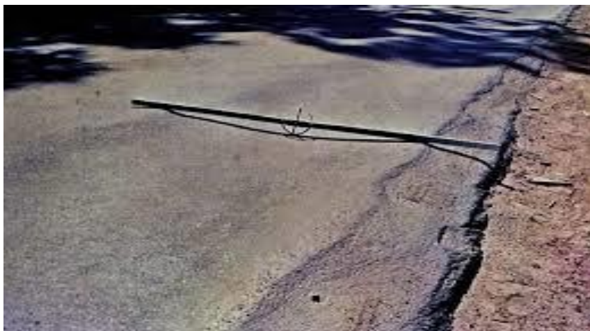
Figura 17 – Afundamento plástico Fonte: Norma DNIT 005/2003 – TER
