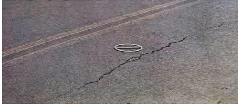
Figura 07 – Trinca longitudinal Fonte: Norma DNIT 005/2003 – TER
